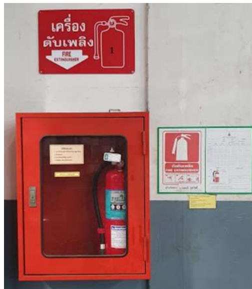
รูปที่ 7.6.4 จุดที่ติดตั้งถังดับเพลิงภายในอาคาร 11
